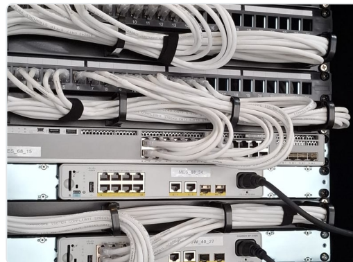
Rack echipat în teren — panouri și patchcord-uri CommScope Cat 7, switch-uri PoE Cisco.
